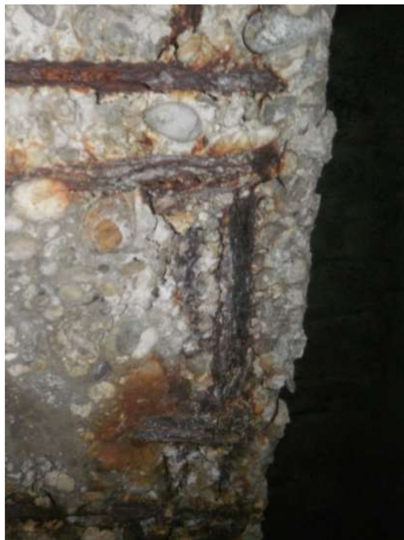
Obr. 4 Detail stavu výstuže hlavnej a konštrukčnej
