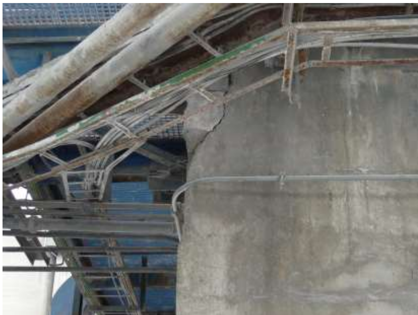
Obr. 13 Pohľad na poruchu uloženia komunikačnej oceľ. koštr. na roh JZ strany
