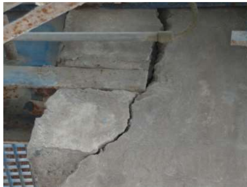
Obr. 14 Detail poruchy uloženia
