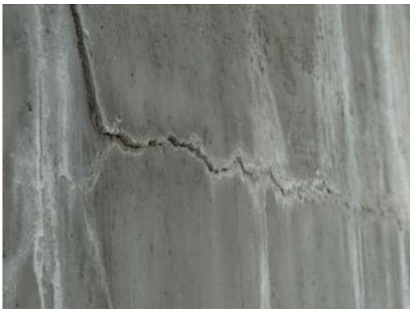
Obr. 19 Detail poruchy steny severnej základu Z3
