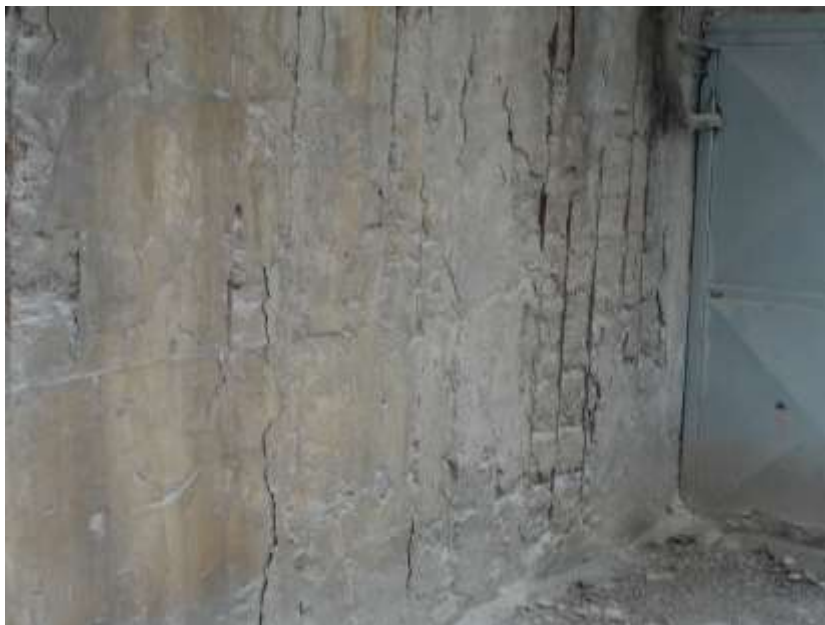
Obr. 5 Pohľad na plošné poruchy východnej steny
