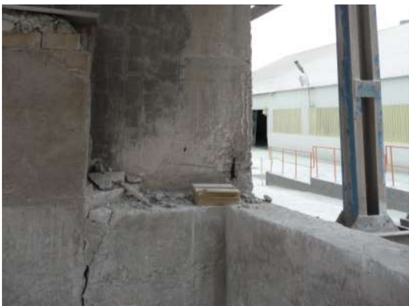
Obr. 11 Pohľady na poruchy základu Z2
