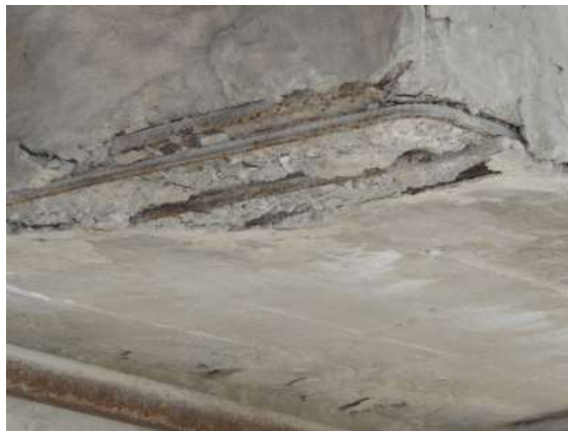
Obr. 6 Detail obnaženej výstuže konzolovej dosky na východnej strane
