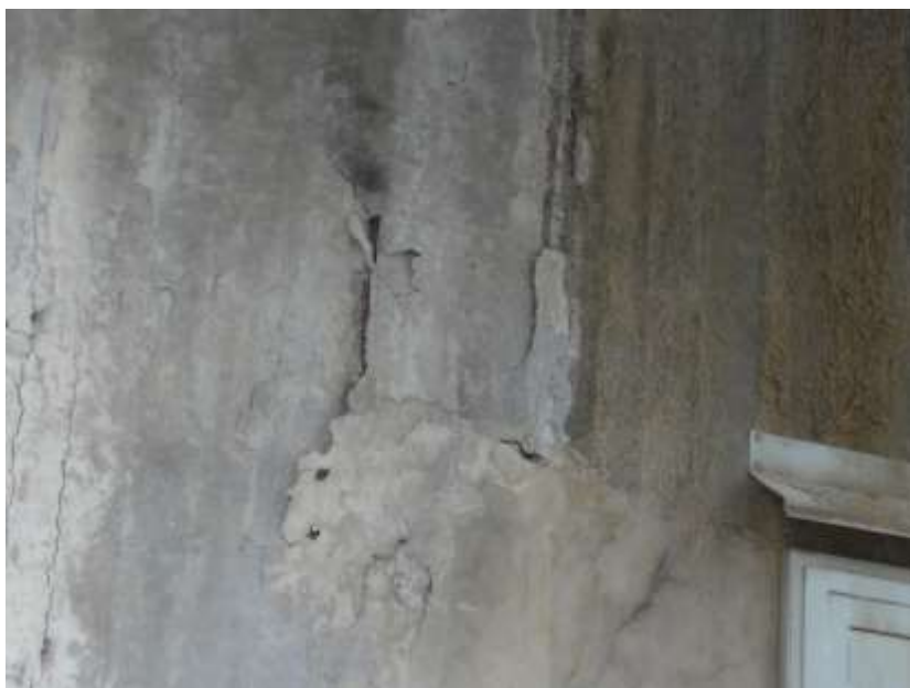
Obr. 7 Pohľad na plošný rozpad povrchu bet. časti zo severnej strany základu Z1
