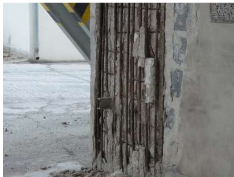
Obr. 4 Detail obnaženej výstuže južnej strany
